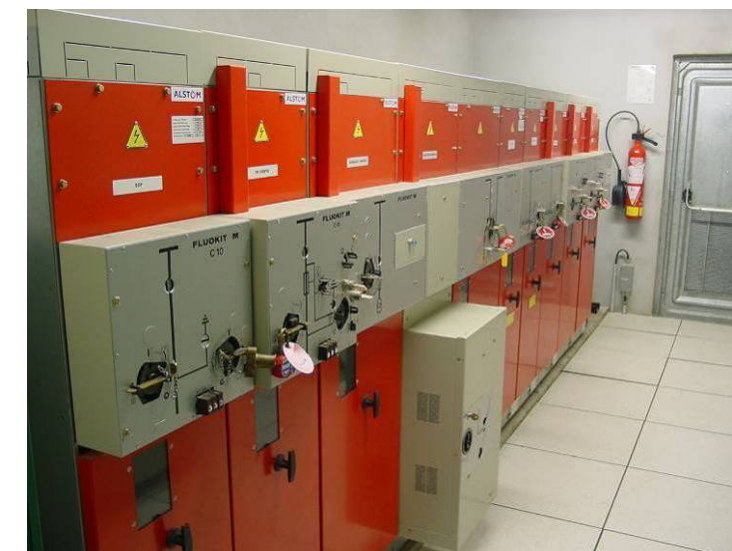
Illustration 12 : Intérieur d'un poste de livraison
